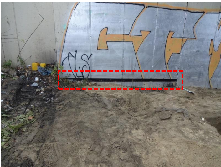
Abbildung 17: Spalt (quer) mit dahinter liegendem Hohlraum am nordwestlichen Brückenende
