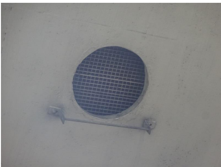
Abbildung 15: vergitterte Öffnung an Brückenunterseite
